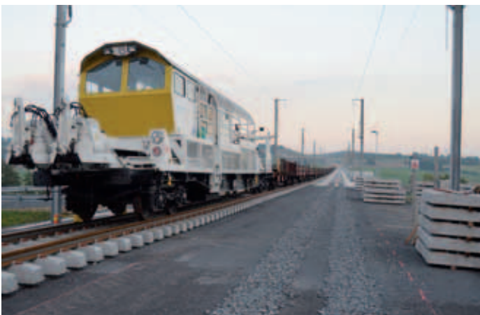
Wagon pousseur avec les rails derrière
