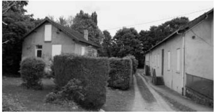
Etat actuel des caches de la salle paroissiale et de la maisonnette à l'arrière du presbytere
