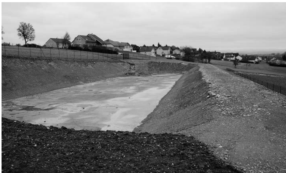
Bassin de rétention d'eau
